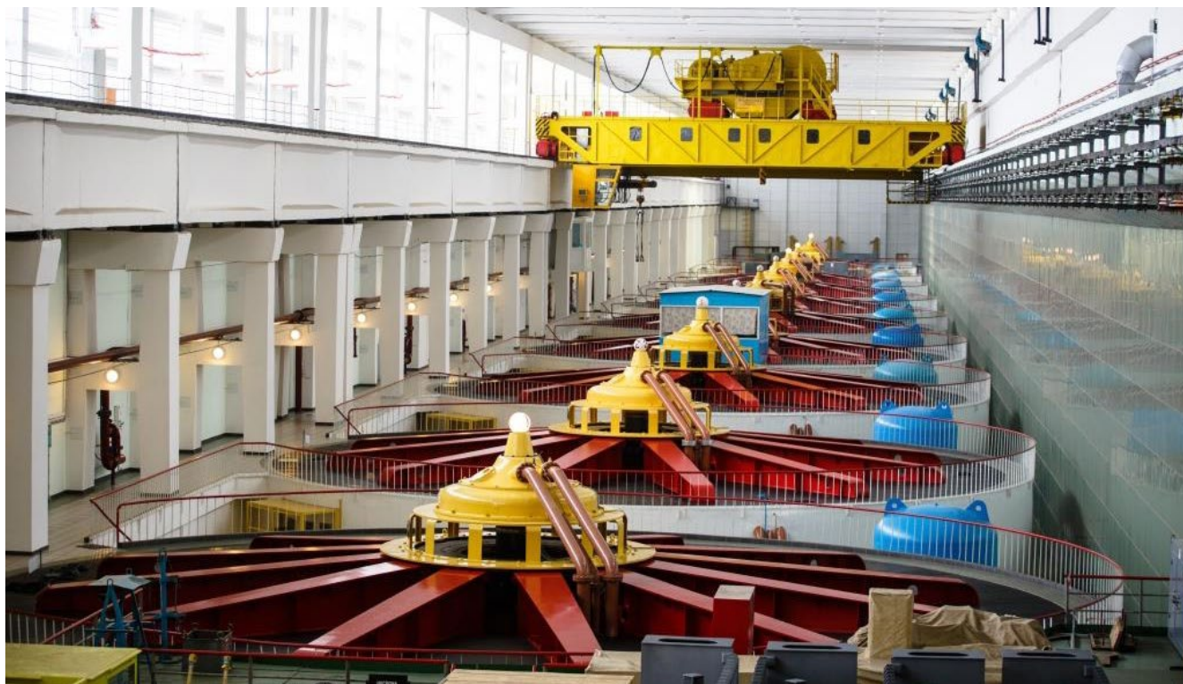
На Воткинской ГЭС впервые в истории ЕЭС России ввели в работу автоматизированную систему дистанционного управления оборудованием распредустройств ГЭС из диспетчерских центров Системного оператора
